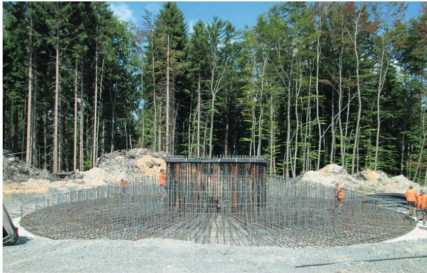
Abbildung 2: Bau des Fundaments einer Windenergieanlage in einem südhessischen Waldgebiet Quelle: Faktenpapier Windenergie in Hessen
